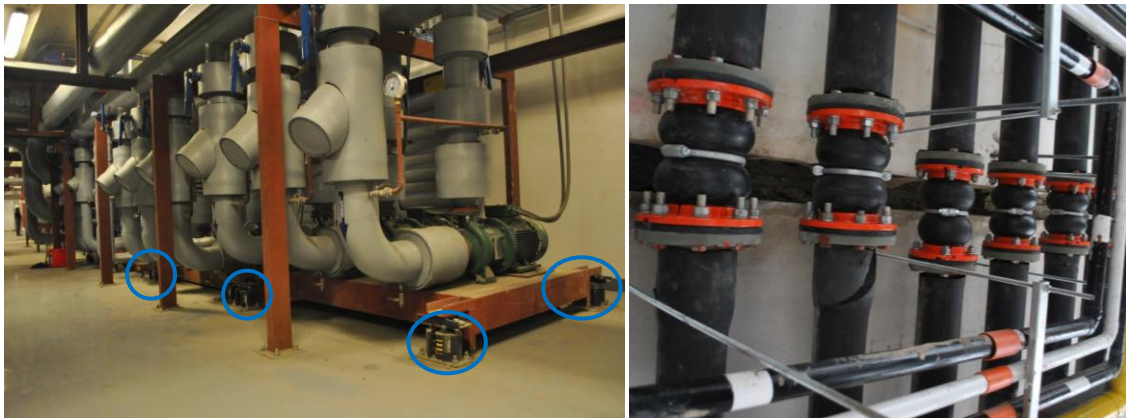
Figura 6. Aplicación en sala de clima de Hospital. Aisladores de vibración de resorte (círculos azules) con restricción sísmica en bombas de agua y juntas de dilatación.
