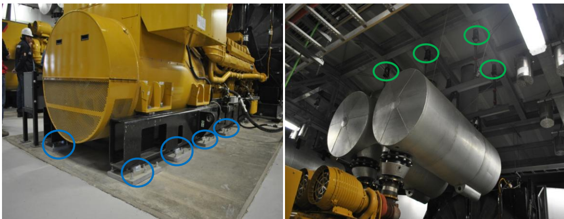
Figura 7. Aplicación en sala de grupo electrógeno de Planta de Gas. Aisladores de vibración de neopreno con restricción sísmica (círculos azules) en grupos electrógenos y colgadores de resorte (círculos verdes) con arriostramientos sísmicos en silenciadores de escape de gases.
