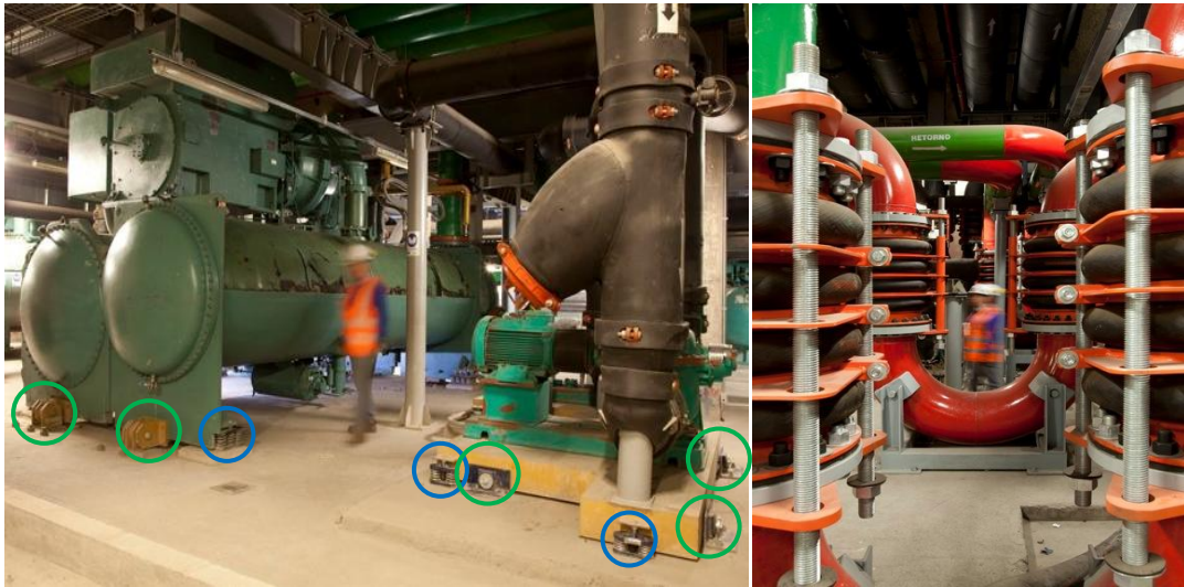
Figura 5. Aplicación en piso mecánico de Mall Comercial. Aisladores de vibración de resorte (círculos azules) y restrictores sísmicos (círculos verdes) en enfriadores de agua (chillers) y bombas de agua y juntas de dilatación.
