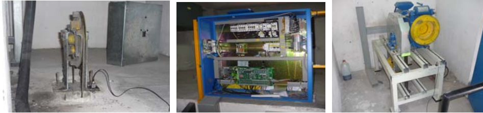
Imágenes del reductor, cuadro de contactores y motor respectivamente.
